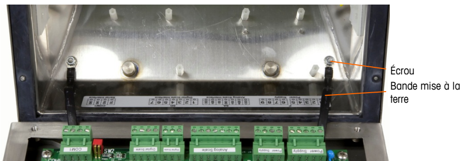
Figure 3-11: Desserrage des bandes de mise à la terre
