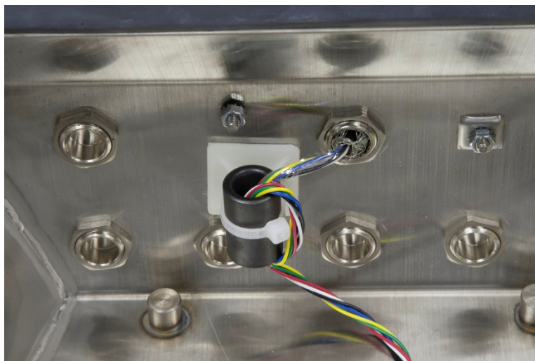
Figura 3-14: Nucleo di ferrite installato
