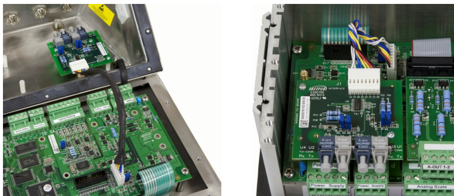
Figura 3-42: Tarjeta de interfase de fibra óptica
